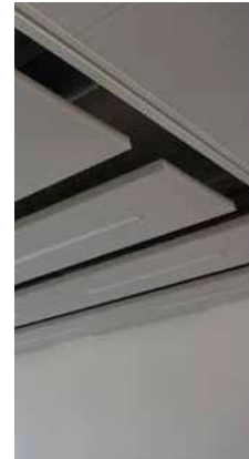
Spezielle Kühldecken sorgen für angenehmes Raumklima.
